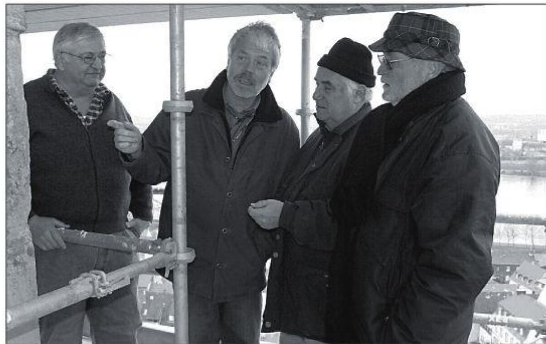
Dachdeckermeister Rainer Will, Architekt Hans-Joachim Becker, Werner Merkler vom Verwaltungsrat der Gemeinde und Pastor Stephan Augst begutachten die Schäden in luftiger Höhe des Turmes ■ Foto: Andrea Dörper
